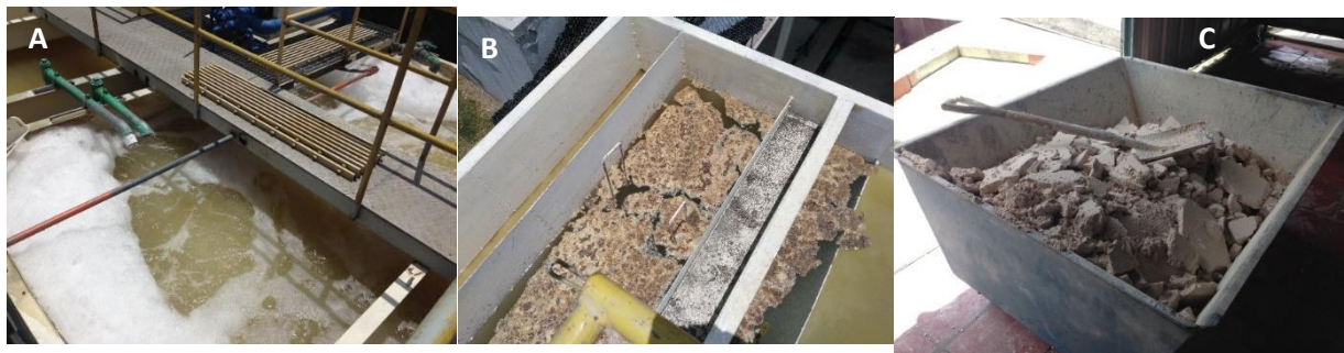
Figura 3. A. Vista interna de los biodigestores; B. Formación de lodos por acción de bacterias; C. Residuos sólidos finales, mezcla de lodos de grasa con cal después del proceso de prensado.
